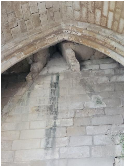
Figure 15 : conduit de cheminée
